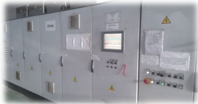
Главный распределительный электрощит
